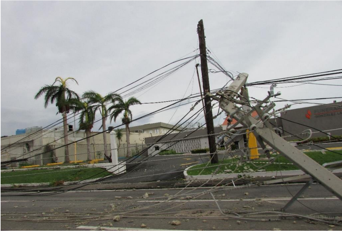
Figura 23 – Postes de distribución en madera y hormigón derribados en la Avenida 65 de Infantería, en Puerto Rico
